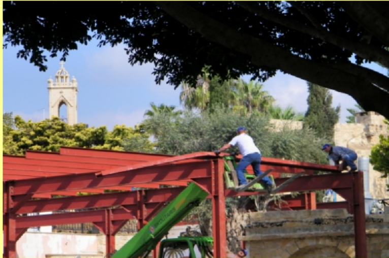
Hier wird ohne Rücksicht auf deutsche Sicherheitsvorgaben eine Halle aufgebaut, an einem Sonntag.
